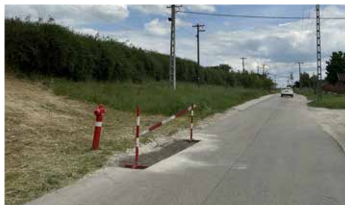
Ha az aszfaltozás túl korán történik, az új burkolat megsüllyedhet, repedezhet
