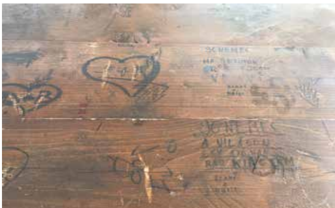
A játszótéri szatelli asztala is borzasztó állapotban van
